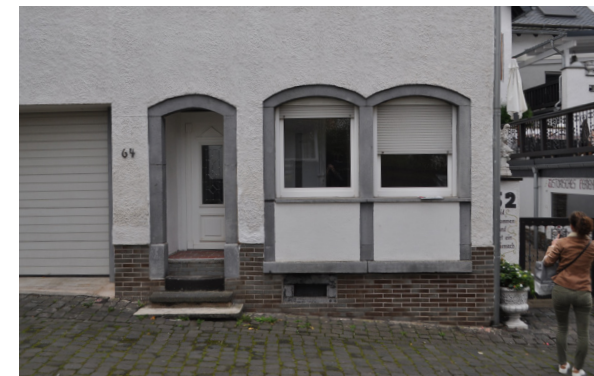
Abb. 50 Die frühere Gliederung des Schaufensters bleibt ablesbar. Störend sind der Flachsturz und die Rollladenkästen. Foto: Johannes Buchhammer, Oktober 2024
