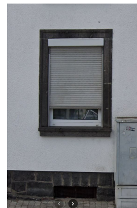
Abb. 96 Außen aufgesetzter Rollladenkasten
