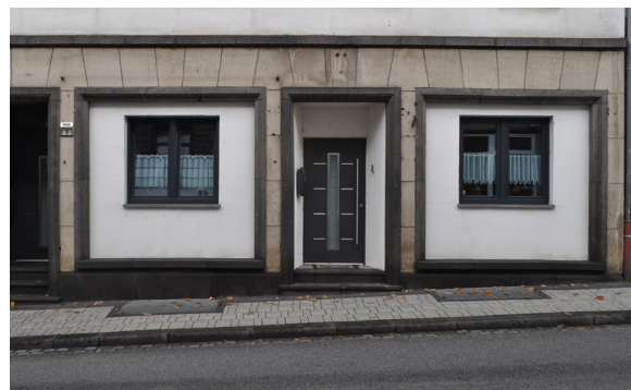
Abb. 49 Die neuen Fenster sind deutlich kleiner als die früheren Schaufenster und sitzen deshalb etwas verloren in den weiß verputzten Flächen. Auch die neue Tür füllt den alten Türrahmen aus Basaltlava nicht aus. Es wäre gestalterisch überzeugender und würde auch die Belichtung der Räume verbessern, wenn die neuen Öffnungen die volle Breite der alten Schaufenster aufweisen würden. Foto: Johannes Buchhammer, Oktober 2024
