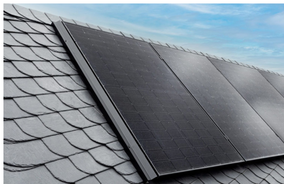
Abb. 68 Aufdach-Photovoltaikanlage. Solche Anlagen können nachträglich auf Schieferdächer aufgebracht werden. Foto: Rathscheck Schiefer, 2026
